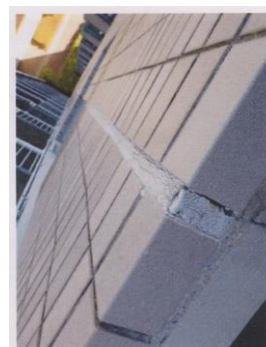
シーリング材の劣化
